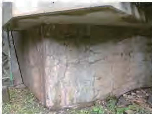
図-2 A1 橋台の外観変状
