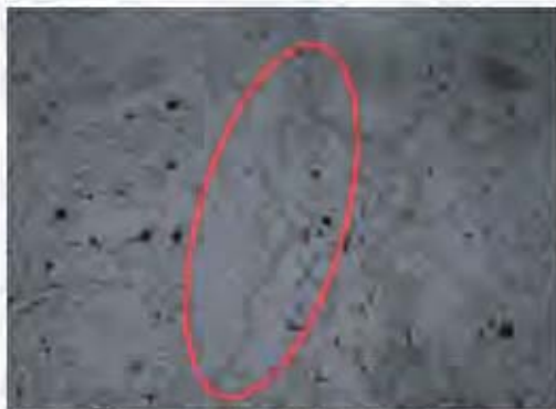
図-5 ひび割れ注入跡の状況
